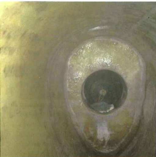
Blick auf den verdeckten Übergang DN 400 auf EI 800/1200.
