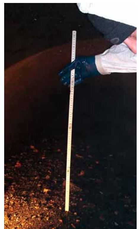
40% Verschmutzungsgrad Altrrohr DN 1500 mm.
