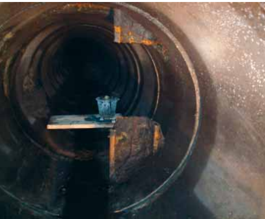
Einragende Spundwand in Altrrohr DN 1500 mm.
